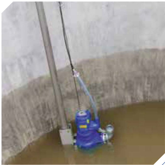
FÖRDERUNG DER AUFBEREITETEN GÜLLE ZUM SPEZIELLEN PRESSSCHNECKENSEPARATOR
