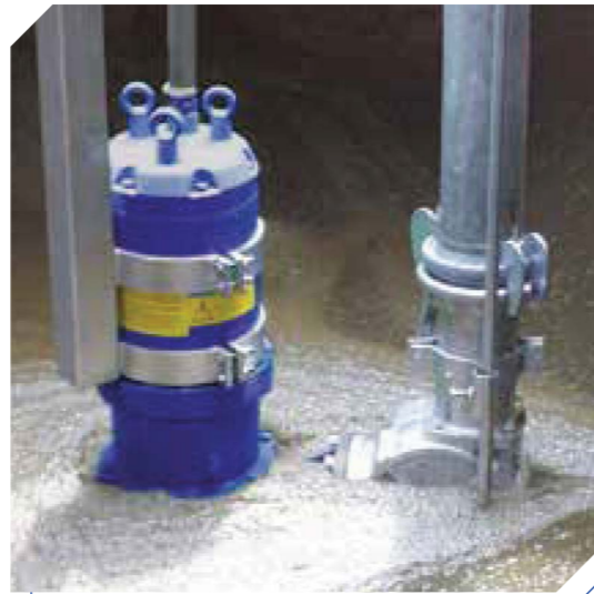
BESCHICKUNG DER ANLAGE MIT EINER SPEZIELLEN TAUCHMOTORSCHNEIDPUMPE
