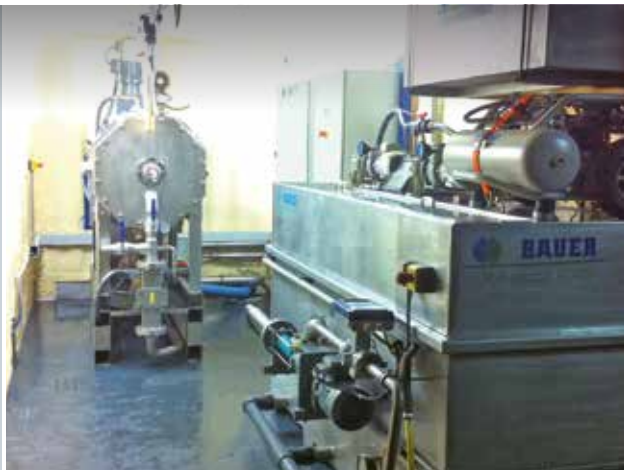
SPS – Schlammpresse mit Flockungsmittelstation SPS – Sludge Press with flocculating aging station
