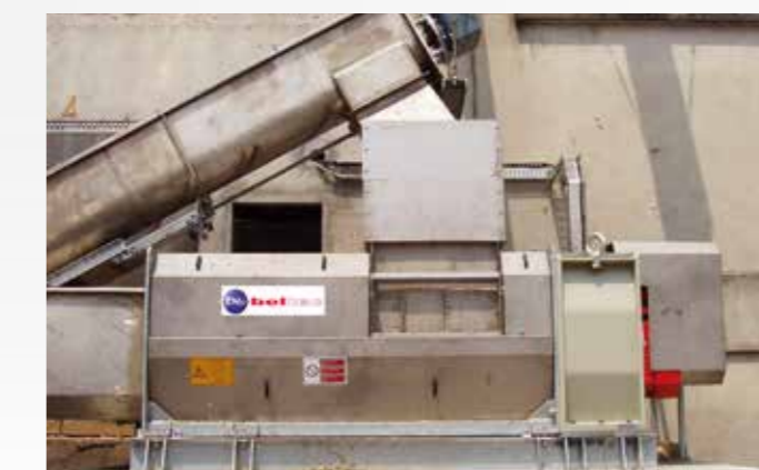
BP – Desagüe de desechos de la despulpadora / BP – Drenagem de rejeitos de celulose
